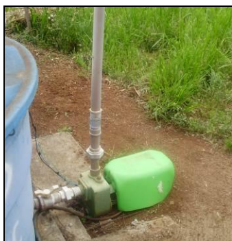
Figura 3: Bomba que alimenta o filtro vertical
