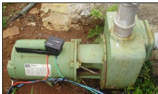
Figura 4: Horímetro instalado na bomba
