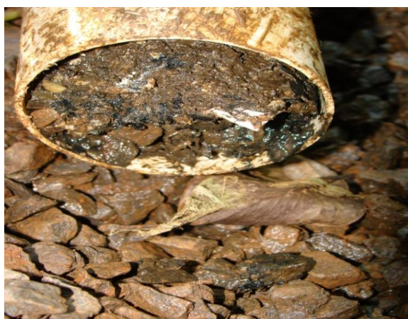
Figura 11- Tubulação de 100 mm entupida, que faz a distribuição do afluente da estação.
