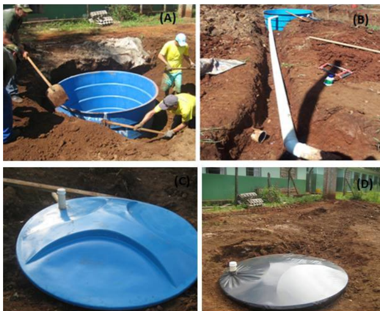
Figura 1: Fossa séptica. (A): Colocação da caixa de fibra de 5m 3 ; (B): Saída do esgoto sanitário da escola para a fossa séptica; (C): Abertura na caixa para realização da limpeza da fossa; (D): Fossa séptica finalizada.
