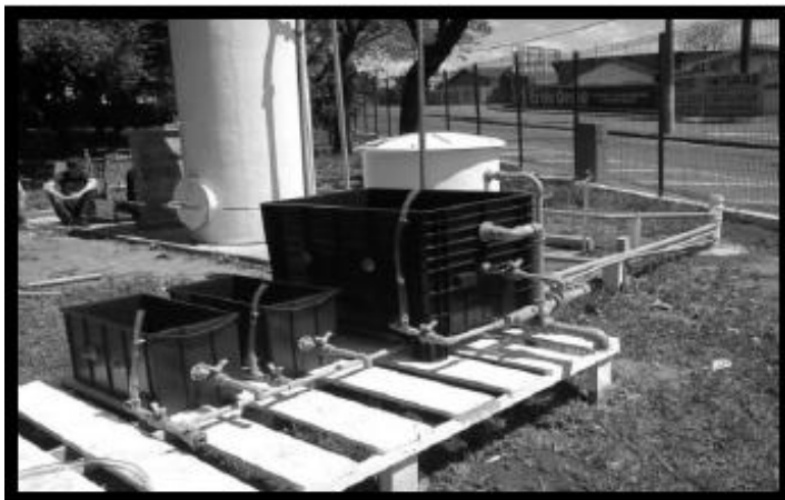
Figura 1 – Vista geral do sistema instalado RAFA e wetland para pós-tratamento do efluente.
