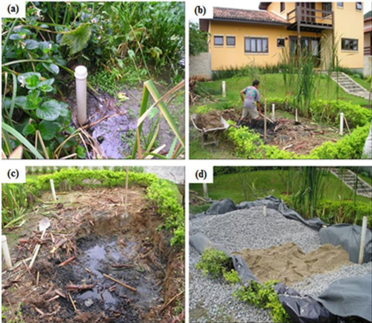
Figura 3 – Fotos do fenômeno de colmatção no WCH do Sistema 2. (a) empoçamento no leito filtrante; (b) remoção manual do material; (c) características do material colmatado; (d) reposição de novo material filtrante
