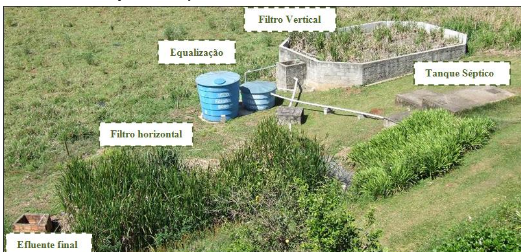
Figura 1 – Estação de tratamento de efluentes do CETREVI.
