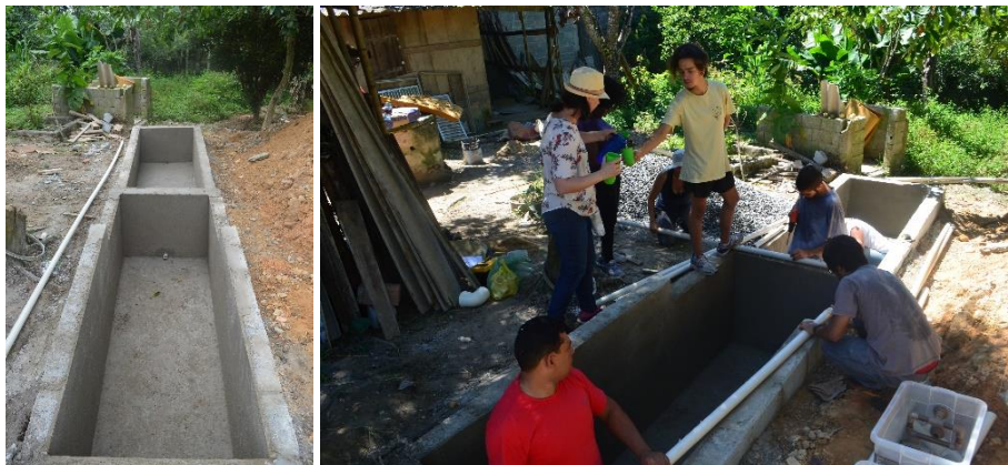
Figura 2 – Jardim filtrante e capacitação
