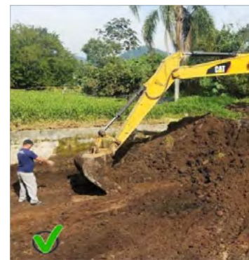
Figura 6: Retirada de lodo mineralizado após 15 anos (Fonte: Manual da ETE Santa Helena, Rotária do Brasil).
