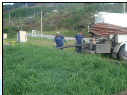
FIGURA 1 - aplicação de lodo de caminhão limpa-fossa na wetland real
