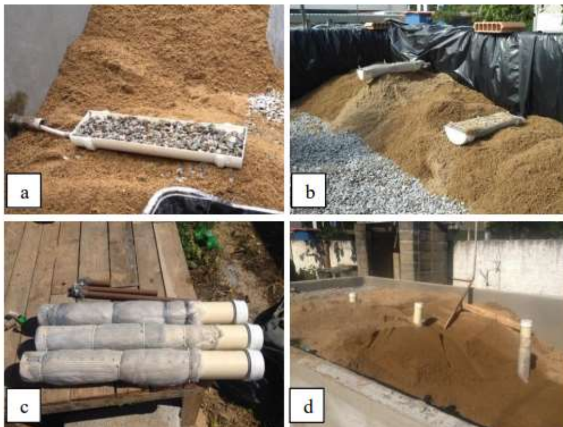
Figura 1 - Implantação de amostradores em pontos intermediários nas unidades WCV e WCH. a) Detalhe construtivo do amostrador insaturado com preenchimento de brita; b) Posicionamento dos dois amostradores a 30 e 50 cm da superfície; c) Detalhe construtivo dos piezômetros/amostradores saturados; d) Posicionamento dos três piezômetros ao longo do WCH.
