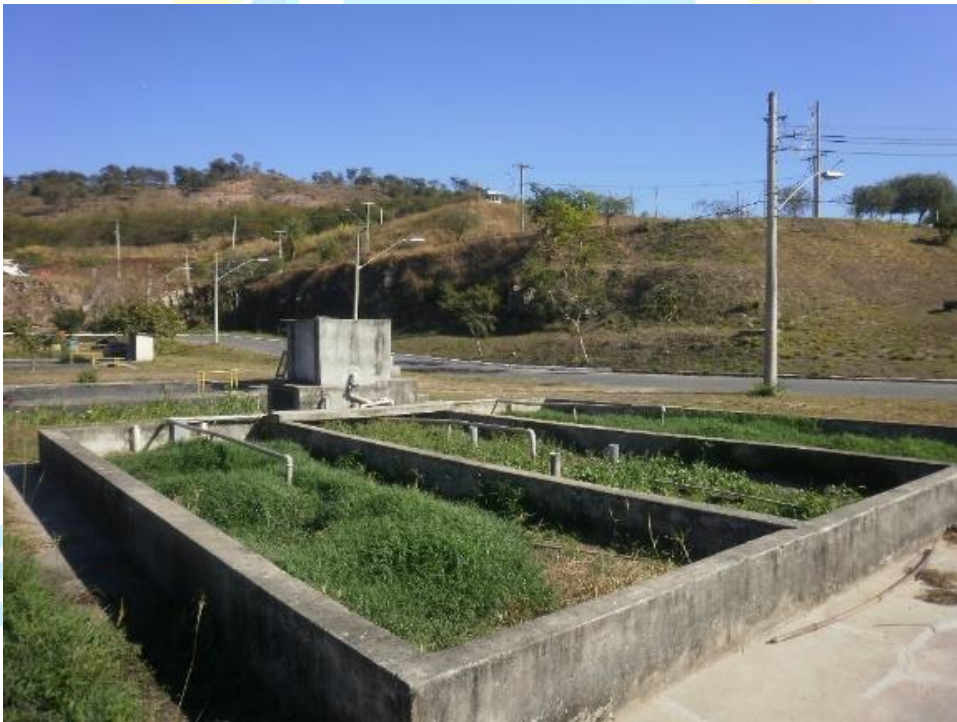
Figura 5: Wetlands para tratamento de esgoto sanitário no CePTS - UFMG/COPASA.
